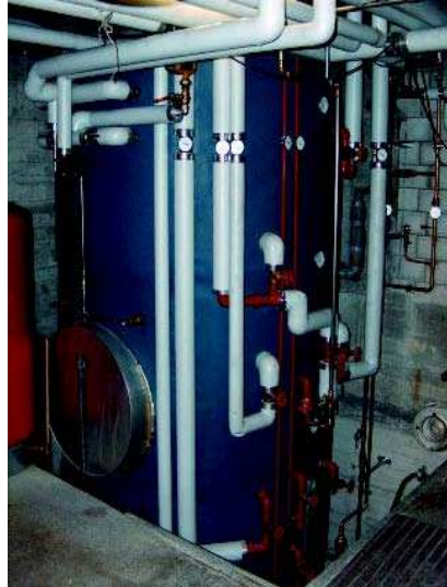
Abb.6: Swiss Solartank für die Kälte-WRG der Metzgerei Salvisberg
